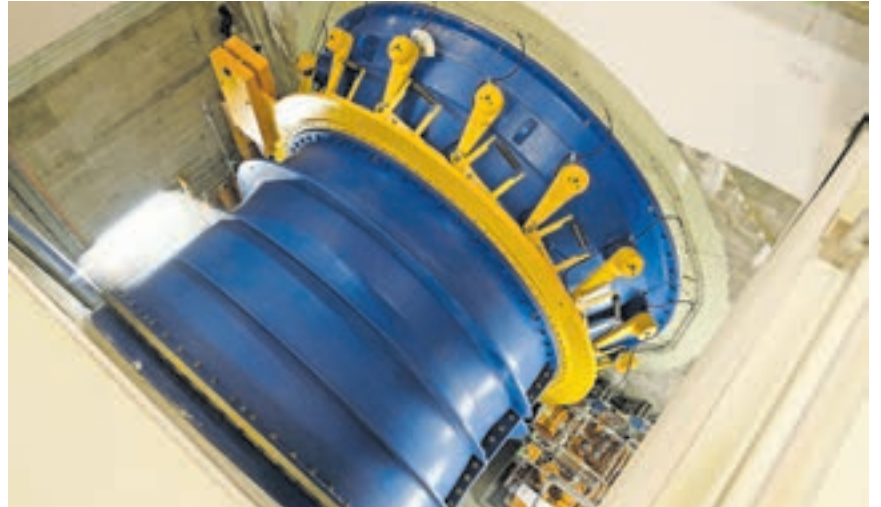
Eine der vier riesigen Turbinen, durch die bis 90m 3 Wasser pro Sekunde fliessen
